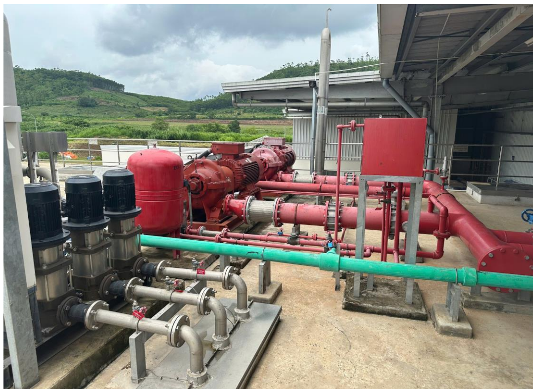
Hình 3.22. Hệ thống PCCC của cơ sở
